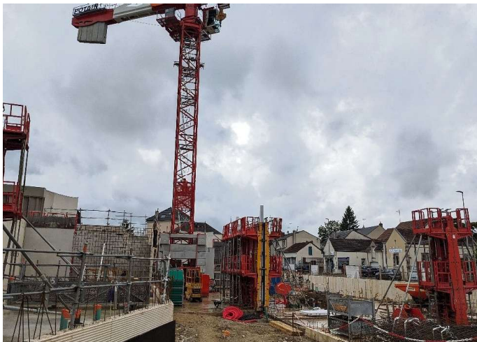
Une grue de 29 mètres de haut installée dans ce qui sera le patio du conservatoire. La démonter sera périlleux.
